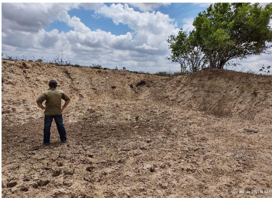
Figura 2.98: Ravinamento ocorrendo na lateral do açude (direita da foto), com de 5m de largura e 1,4m de profundidade, ponto F004 (coordenadas UTM 25S 185965/ 9271069).
